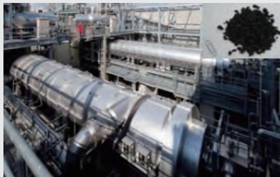
下水汚泥の固形燃料化（広島市）
