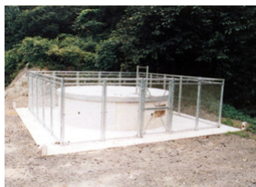
集水井(地上に出ている頭の部分)
